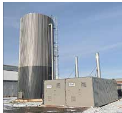
Der Pufferspeicher ist mit rund 17 Metern Höhe der höchste Anlagenteil der Heizzentrale.
